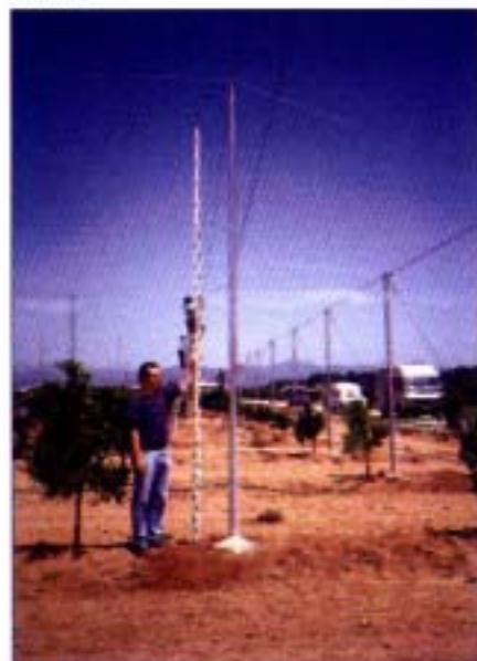
Poste de acero galvanizado de 4,5 m en interior.
